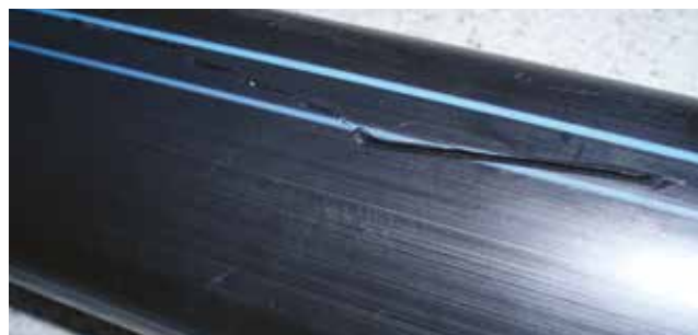
Mechanické poškození trubky
