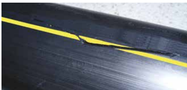
Mechanické poškození trubky
